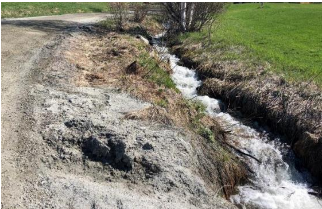
Figur 24: B2 oppstrøms kryssing av Bjorlivegen (Gardsvegen). Mye erosjon ved innløpet.
