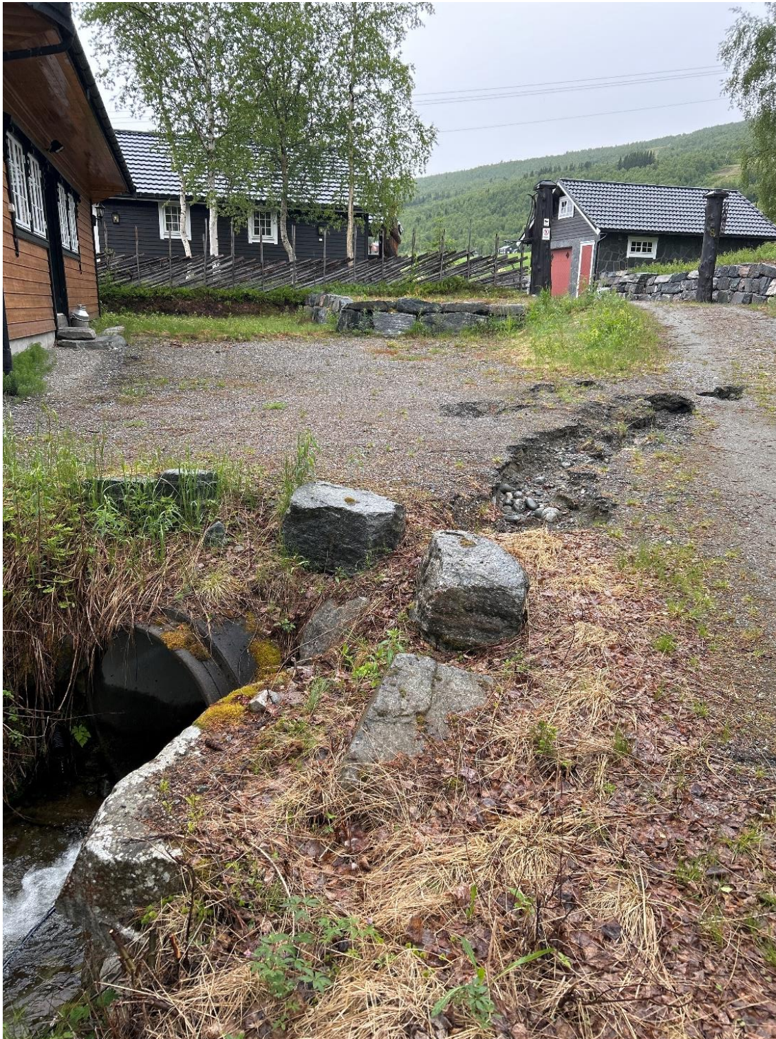
Figur 30: Sårbar stikkrenne ved kryssing 180. Bilde tatt mot oppstrøms.
