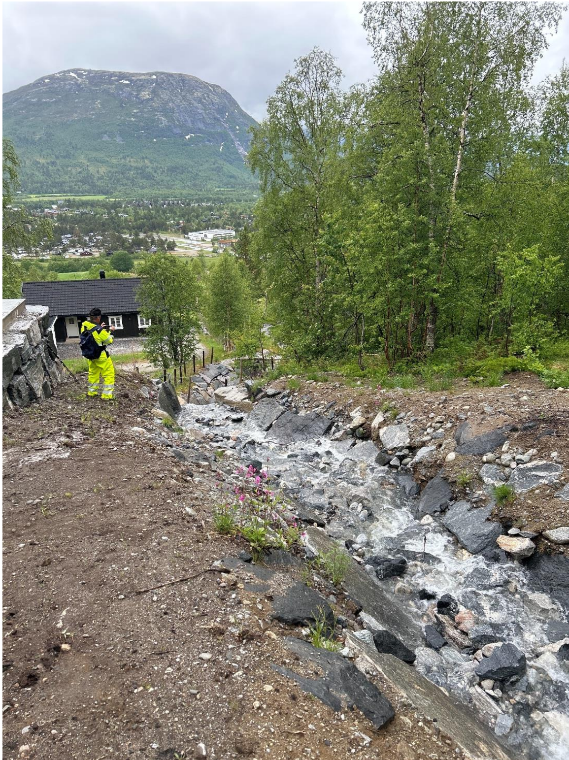
Figur 31: Omlagt bekkeløp ved punkt 32. Dårlig erosjonssikring og hytte alt for nær bekken.
