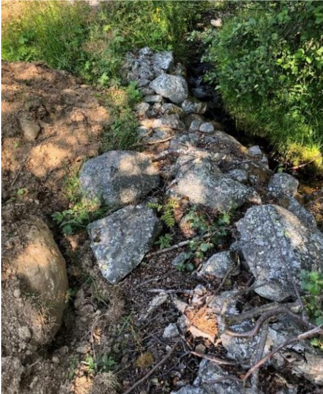
Figur 17: Bekkeløp oppstrøms Toftan, ved punkt 990. Løpet er erosjonssikret, men har svært liten kapasitet. Fare for vann på avveie i en flomsituasjon. (Norconsult AS, 2021)
