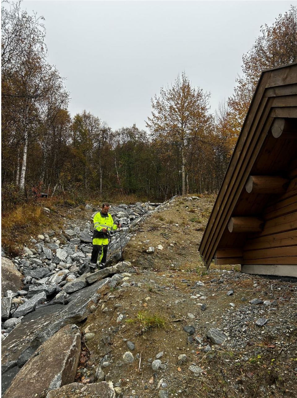
Figur 32: Omlagt bekkeløp ved punkt 32. Erosjonssikring i fare for å bli utvasket. Veldig sårbart område.
