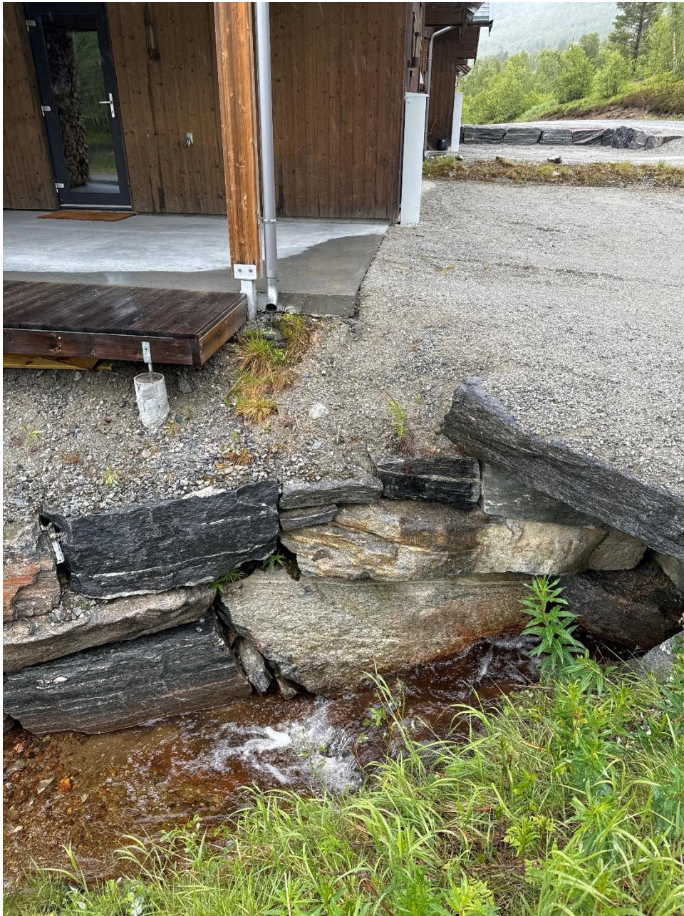
Figur 53: Bekk lagt om i forbindelse med utbygging. Bebyggelse tett på bekkeløpet ved punkt 117. Ingen kantsone.
