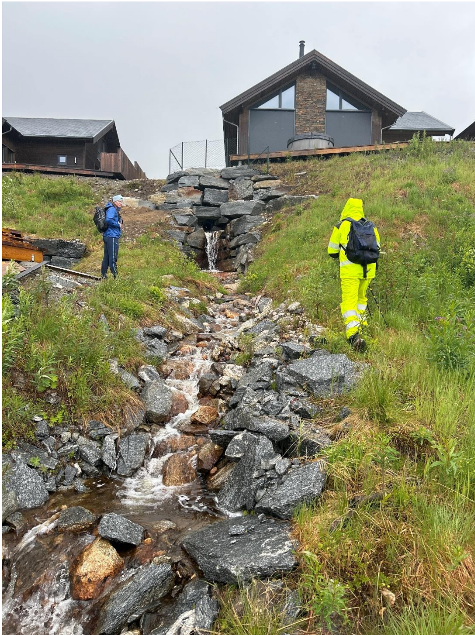
Figur 52: Bekk lagt om i forbindelse med utbygging. Bebyggelse tett på og over bekkeløpet ved punkt 115.
