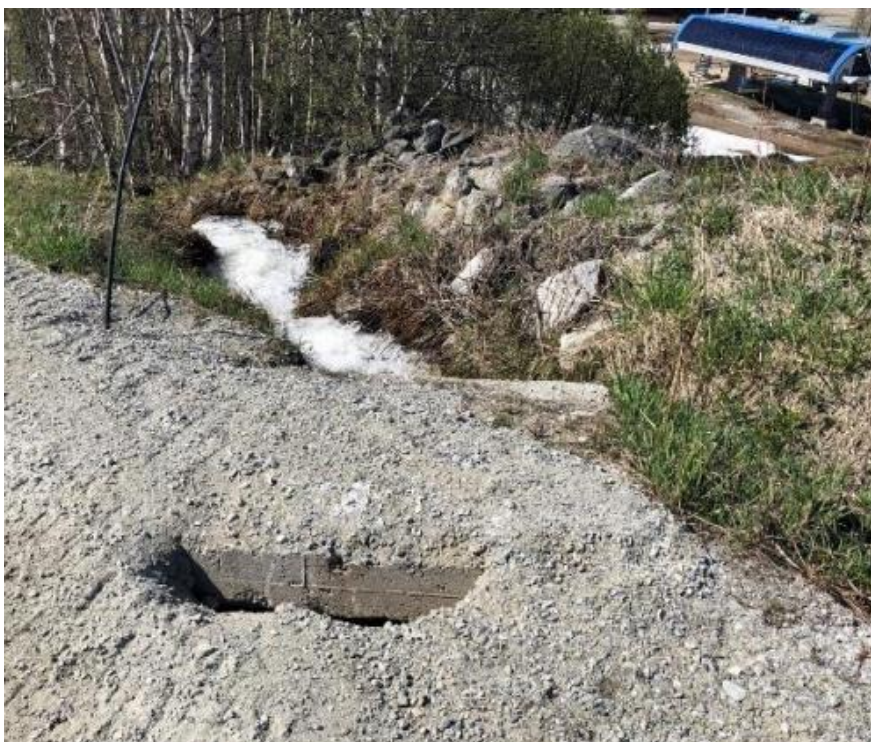
Figur 25: Kryssing av Bjorlivegen (Gardsvegen). Mye erosjon og utvasking rundt stikkrenne.
