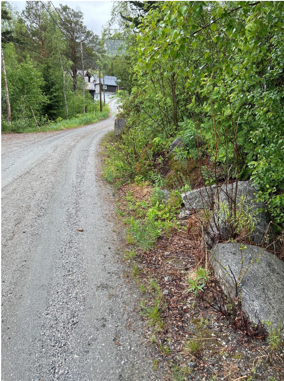
Figur 29: Manglende grøft ved interessepunkt 16.
