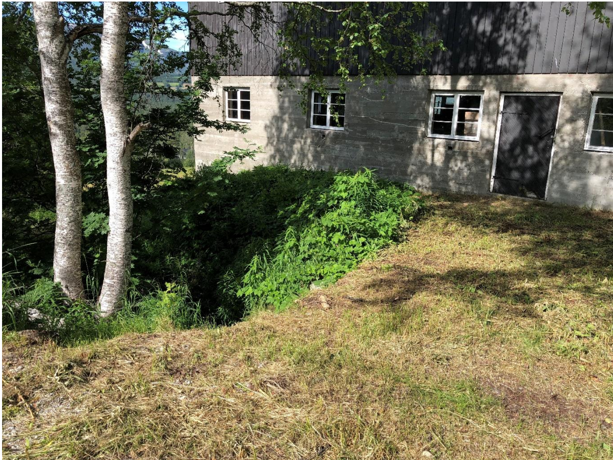
Figur 71: Kryssing (klopp) ved låven langs Morki. Kloppen bør skiftes ut og det bør etableres voll mot låven.
