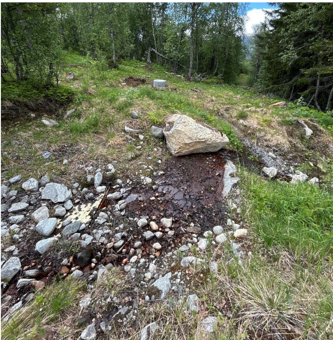
Figur 44: VA-trase ved punkt 57, sett ned mot Jordsengvegen 52.
