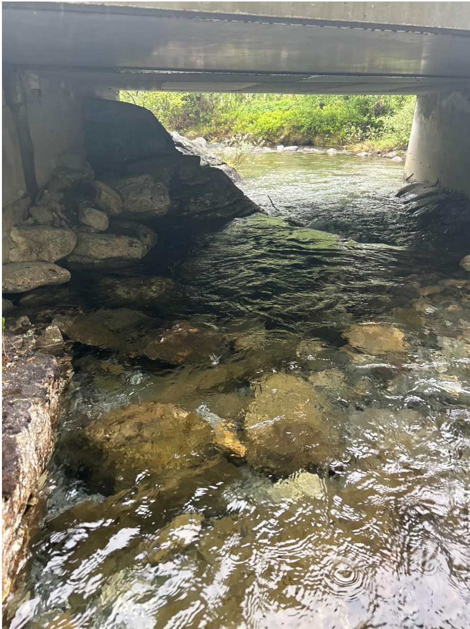
Figur 11: Platebru ved interessepunkt 6. Stor stein under brua forringer kapasiteten.
