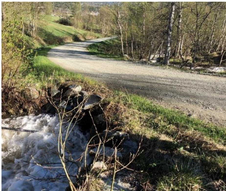
Figur 16: Bilde fra flomsituasjon pinsen 2020. Bildet viser kryssing 450 av Gardsvegen, hvor det er fare for vann på avveie langs grøften på østsiden av Gardsvegen. (Norconsult AS, 2021)
