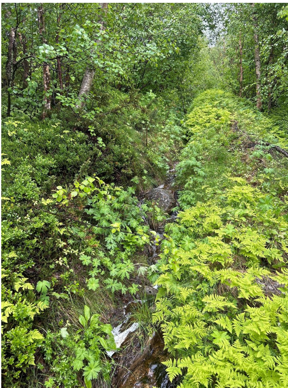
Figur 57: Utgravd kanal, stor fare for kollaps av kanalen her ved punkt 138, samt ved flere andre steder.
