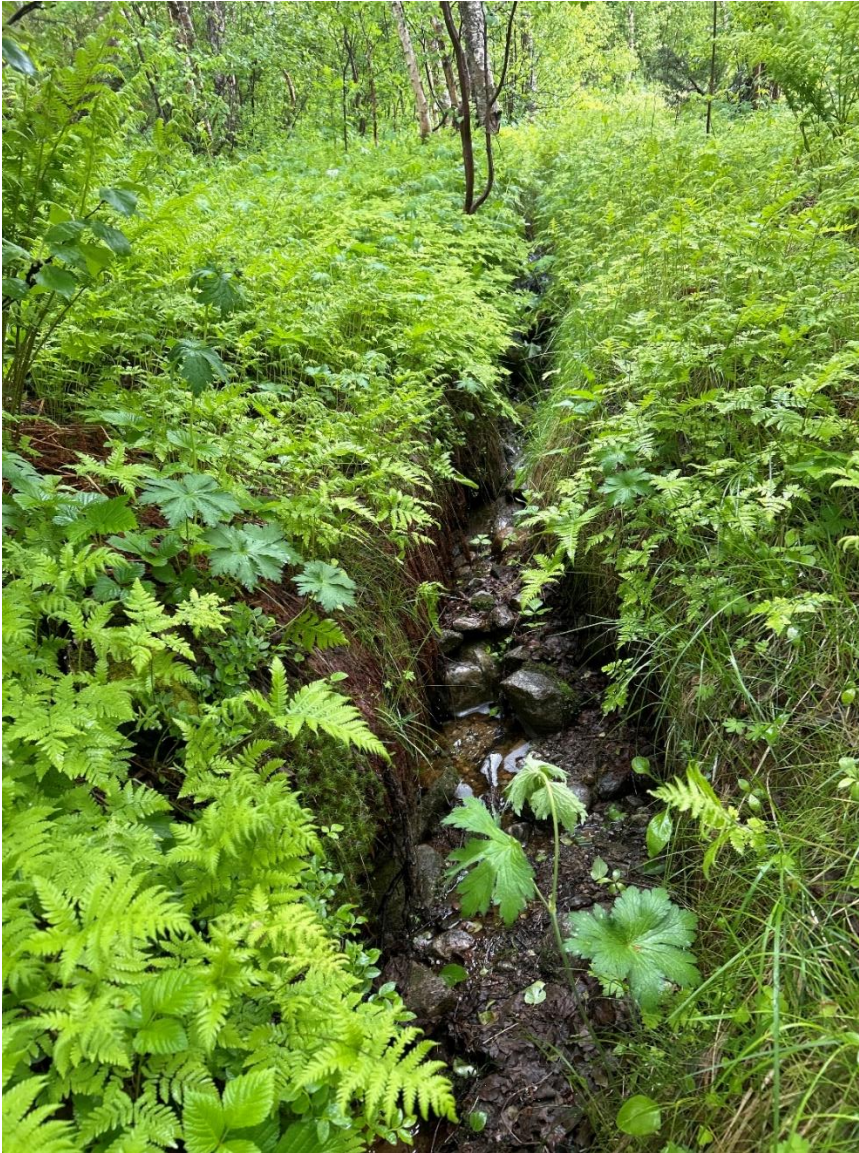
Figur 58: Utgravd kanal, stor fare for kollaps av kanalen her ved punkt 138, sett mot nedstrøms.
