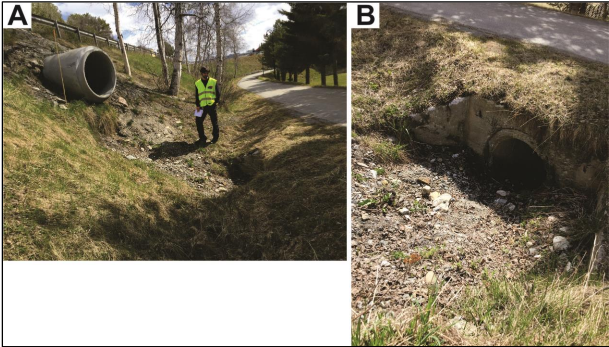
Figur 31: A: Gjennomføring under europavegen går rett i ei ny gjennomføring 1,5 m under som går under Lesja skule. B: Det har samla seg mykje sediment i gjennomføringa over skulen og røyret er byrja å verte fylt opp.
