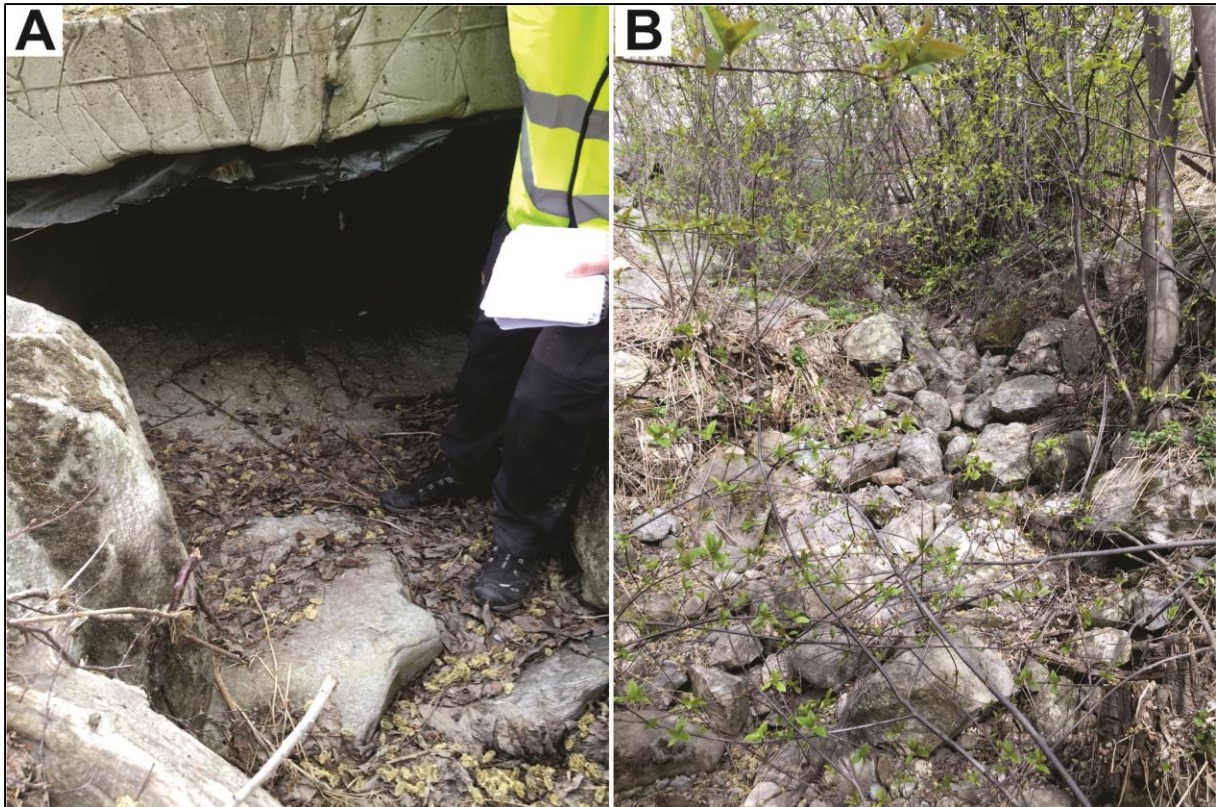
Figur 25: A: Det er god dimensjon på gjennomføringa som går under ein grusveg om lag 50 m sør for europavegen. B: Det har samla seg store mengder lausmassar ovanfor inntaket. Desse kan verte transportert under ein flaum slik at dei blokkerer inntaket.
