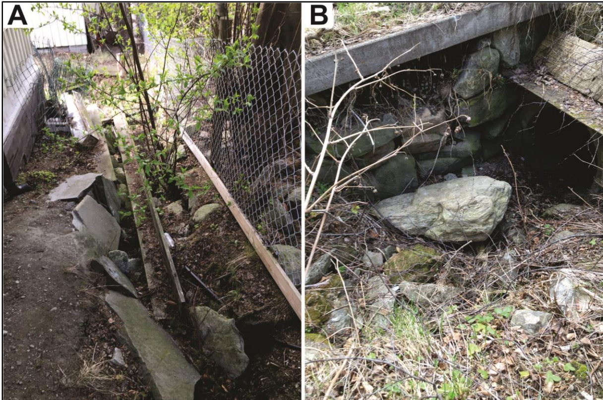
Figur 29: A: Bekkefareet som går under Honnavegen vert ført rett inn i ein garasje på adresse Honnavegen 19 og leia langs veggen her. B: På plenen nedanfor garasjen går det ei gjennomføring ned til jernbanen nedanfor tomta. Her har det samle seg sediment.
