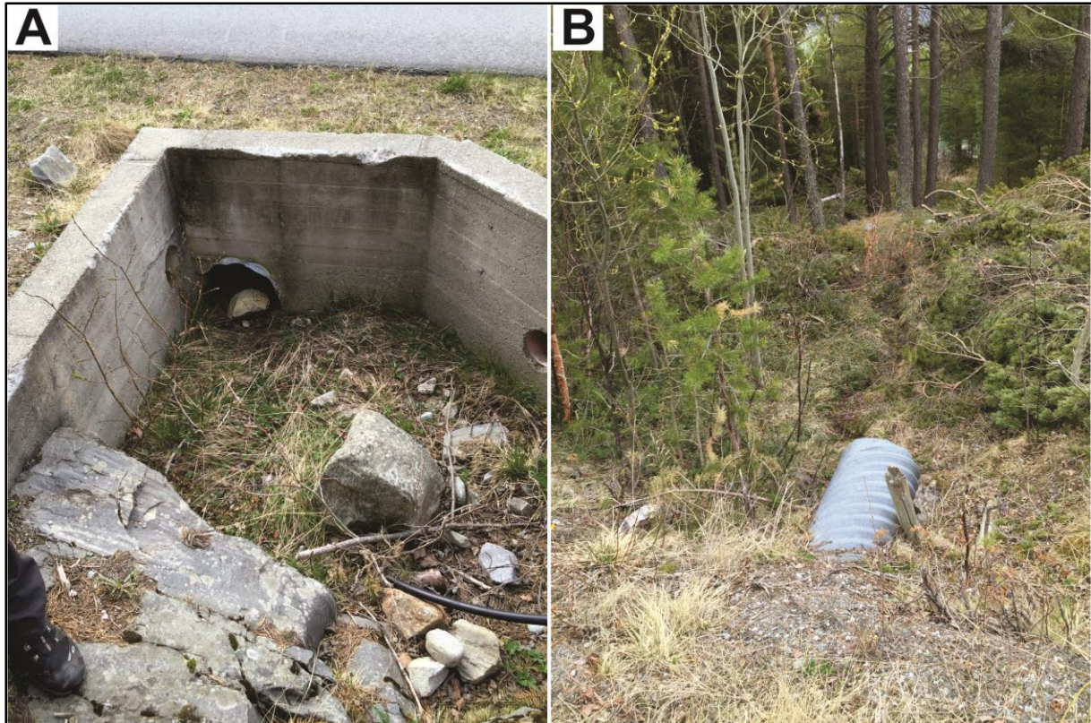
Figur 27: A: Gjennomføring under Skardvegen. Inntaket er fylt med vegetasjon og sediment som vil hindre vassføringa. B: Nedanfor Skardvegen er det ikkje noko definert bekkefar.
