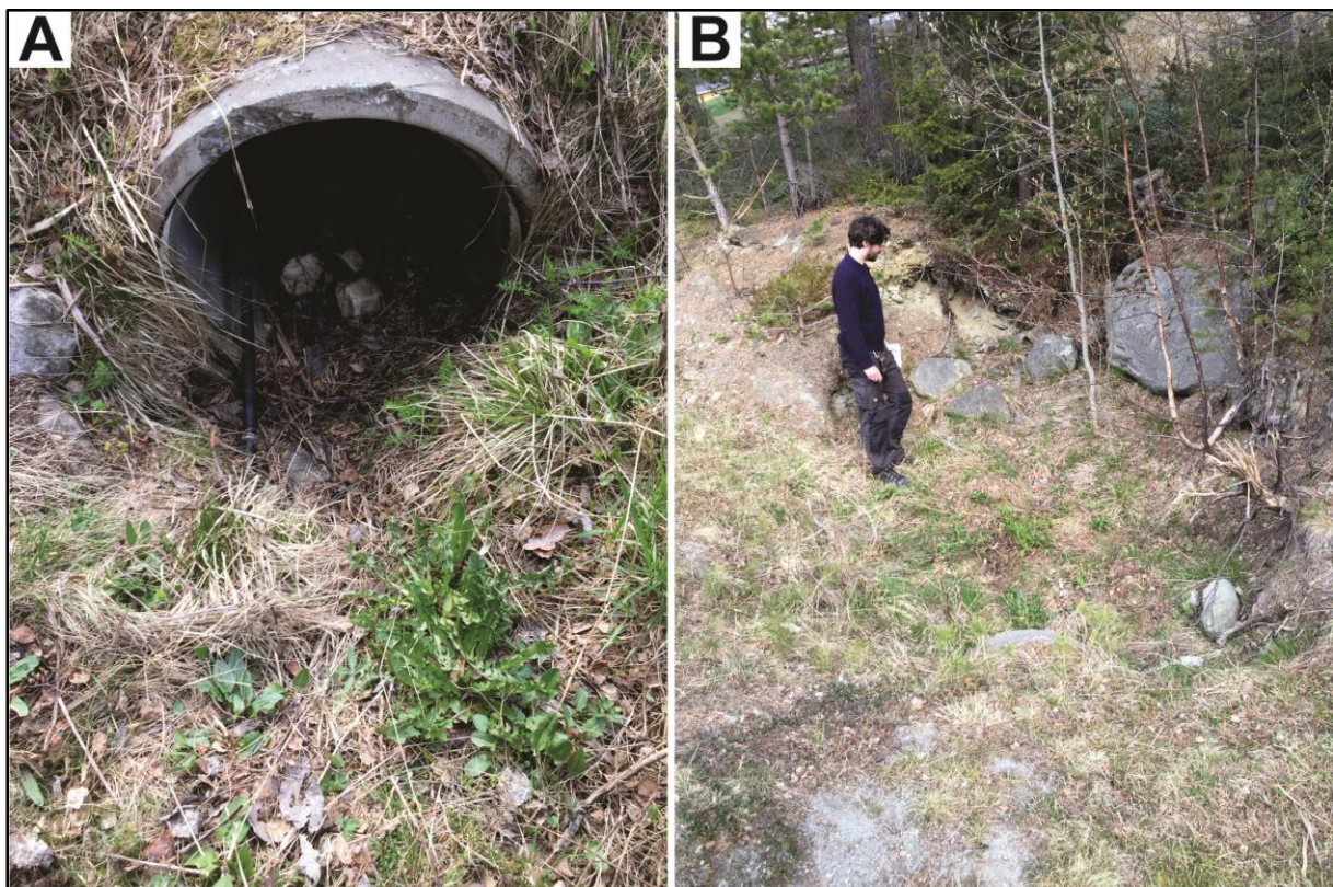
Figur 28: A: I inntaket til gjennomføringa under Honnavegen er det byrja å samle seg vegetasjon og sediment som vil hindre vassføringa. B: Ovanfor inntaket er det tydelege teikn på erosjon.
