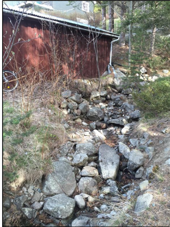
Figur 21: Ved garasjen på gbnr. 103/09 gjer Honna ein yttersving mot det nordlege hjørnet og vil dermed erodere mot veggen til garasjen.
