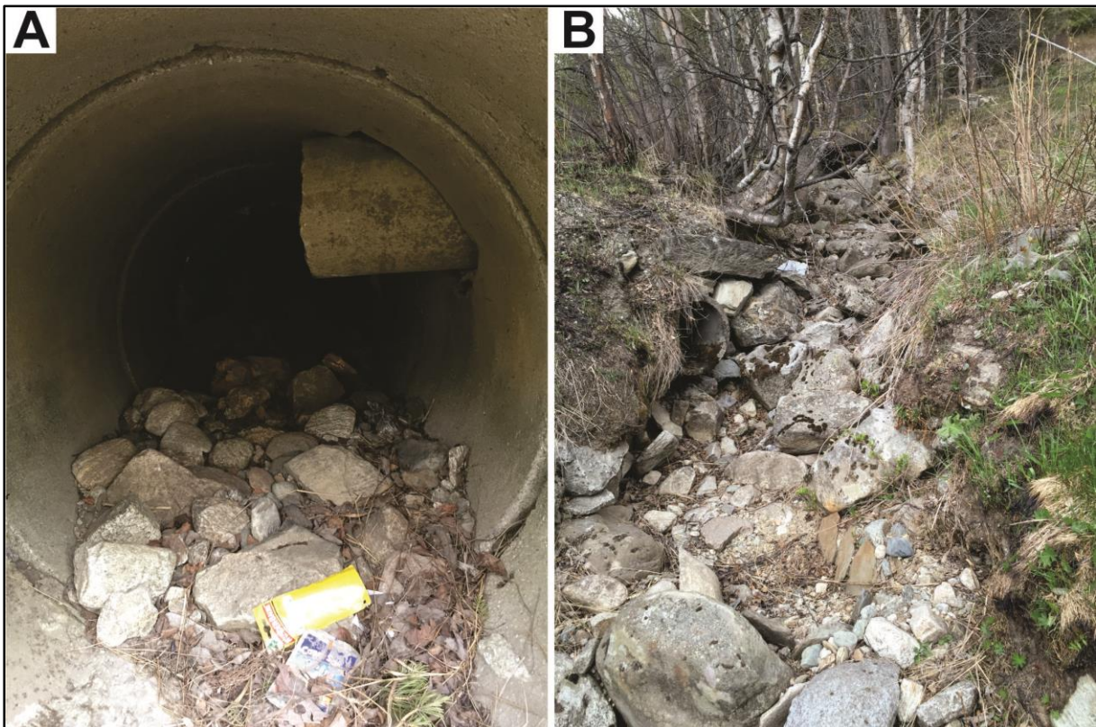
Figur 24: A: 1/3 av betongrøyret under europavegen er fylt igjen av sediment. B: Like ovanfor europavegen er det ikkje noko mur i det heile og det er mykje lausmassar i bekkefareet. Herifrå vert sediment transportert med bekken og avsett i røyret under europavegen.
